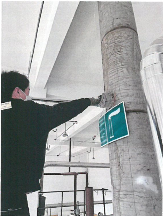
锅炉废气排放口 1#（FQ-21281）G2
