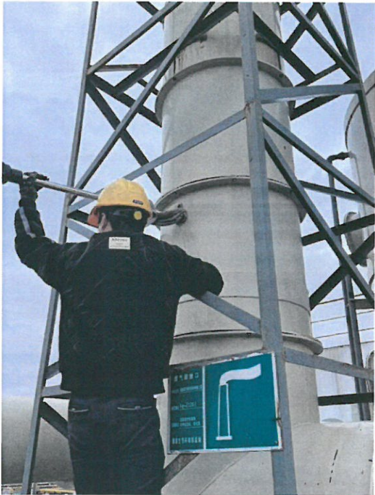
污水处理站废气排放口（FQ-21283）G1
