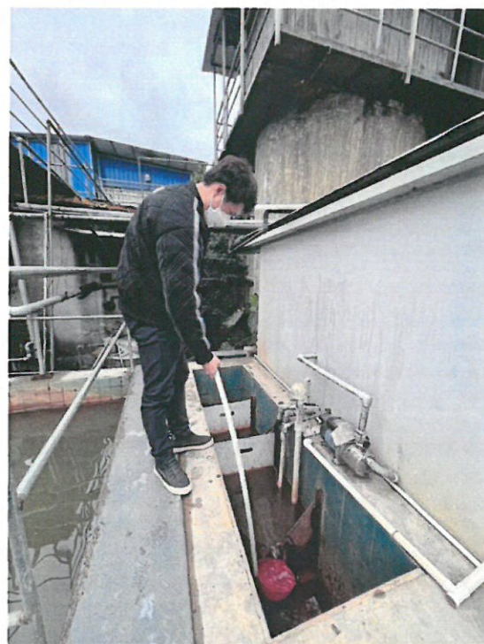
废水处理设施出口 W1
