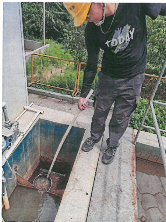
废水处理设施出口 W1
