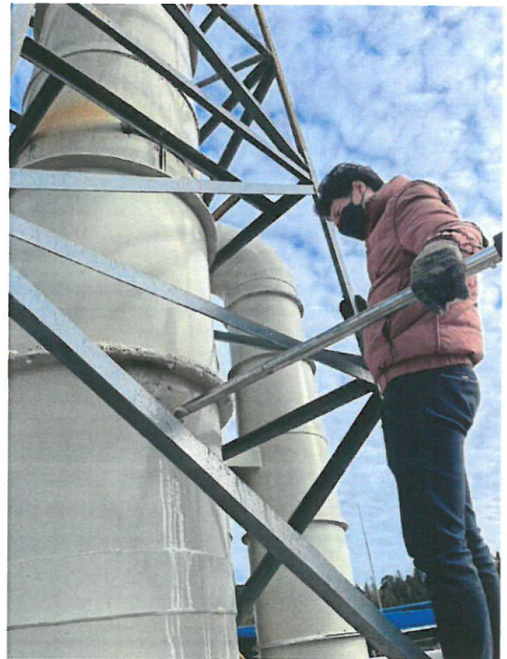
锅炉废气排放口 1# (FQ-21281) G2
