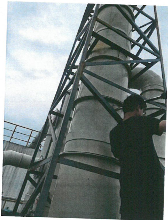
污水处理站废气排放口 (FQ-21283) G1
