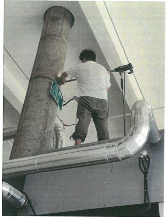
锅炉废气排放口 1# (FQ-21281) G2
