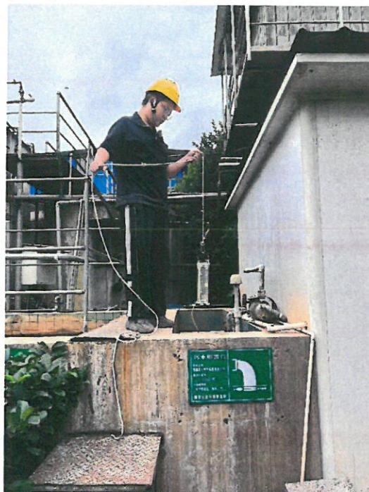
废水处理设施出口 W1
