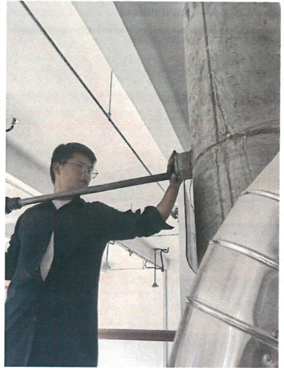
锅炉废气排放口 1# (FQ-21281) G2
